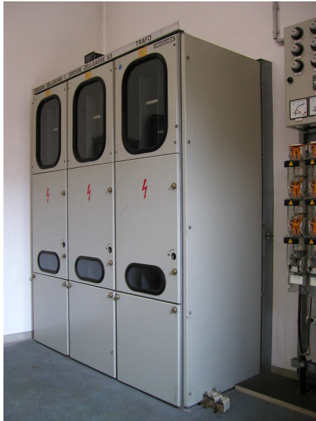
MS-Verteilung im Stationsgebäude
