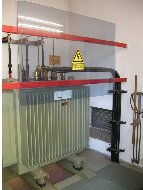
Abschrankung eines Transformators
